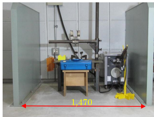
図 4 被覆アーク溶接機ブース
